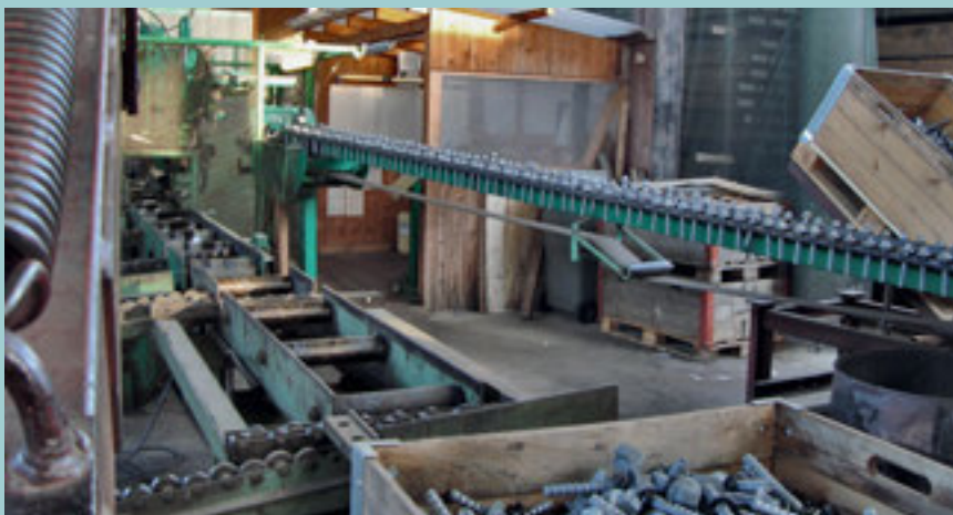
Atelier de montage à Glovelier: les traverses en bois ont besoin de deux plaques nervurées en acier sous les rails, avec huit boulons de fixation, ainsi que d'une plaque antifissures à chaque extrémité. L'acier renchérit le prix des traverses en bois!
