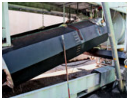
Die beiden parallel eingebauten Reaktoren der Pyreg-Anlage
