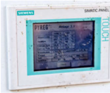
Die Steuerungseinheit der Pyreg-Anlage. Die Steuerung lässt sich auch per Smartphone aus der Ferne bedienen.
