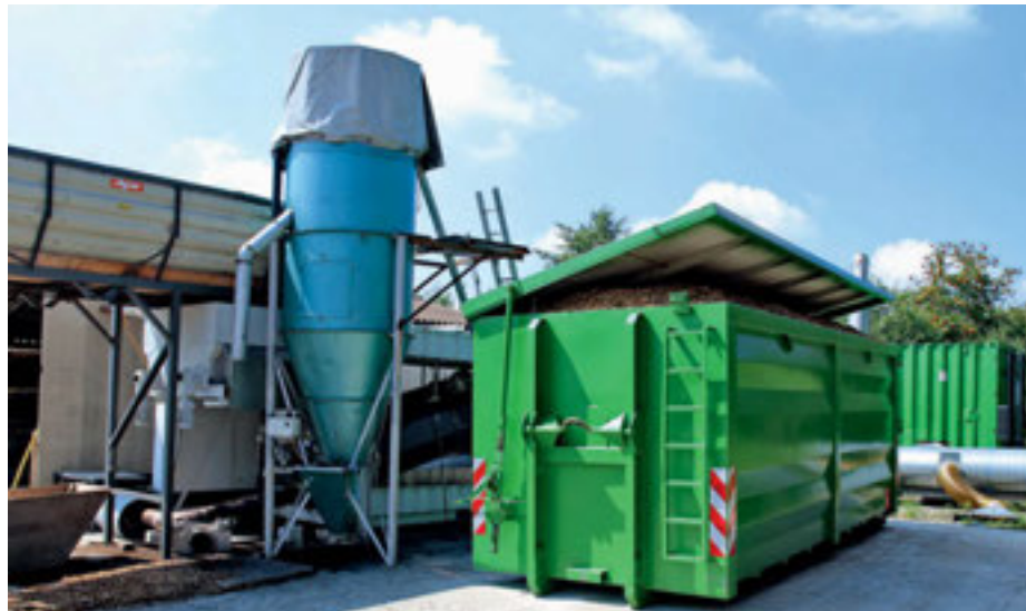
Die Pyreg-Pilotanlage auf Franz Keisers Hof in Neuheim (ZG). Oben links die Dossieranlage, rechts daneben das Kohlesilo. Der hellgrüne Container im Vordergrund rechts ist der mit warmer Abluft gespeiste Trocknungscontainer für Hackschnitzel. Im Hintergrund rechts ist der Warmluftverteiler und der Container des Wärmetauschers zu sehen.
