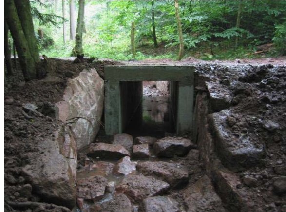
piéd du nouvel ouvrage et enrochements en grès. Les enrochements permettent de réduire l'affouillement en sortie d'ouvrage.
