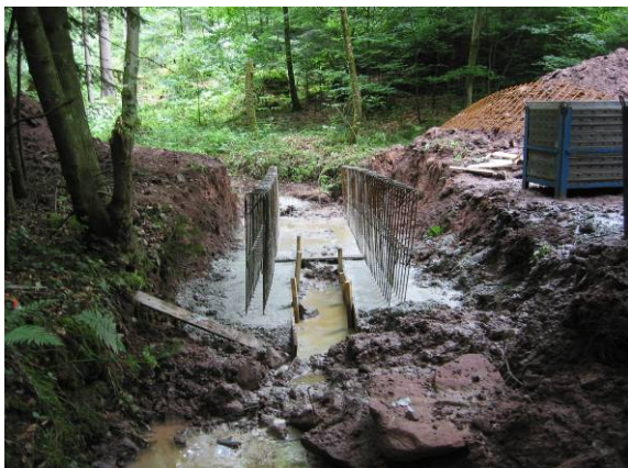
pendant les travaux : après décaissement de la buse pose de l'assise et de l'armature
